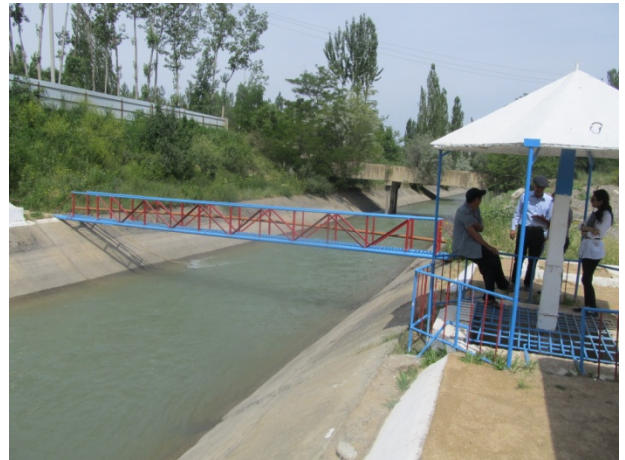
Рисунок 6: Первый гидропост на магистральном канале
